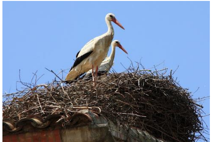
El pes causat per l'acumulació de branques i excrements, suposa un risc de possible esfondrament si no s'hi fan actuacions periòdiques
